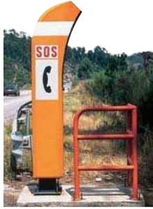
le téléphone de secours emergency phone
